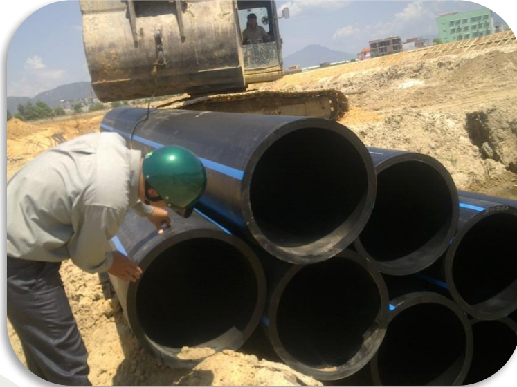
Công trình cấp nước TP Đà Nẵng
